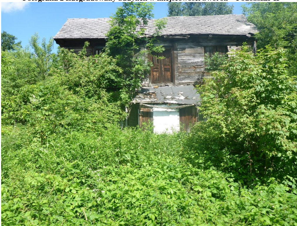
Fotografia 2 Zdegradowany budynek w miejscowości Sworoń – Podobszar II
