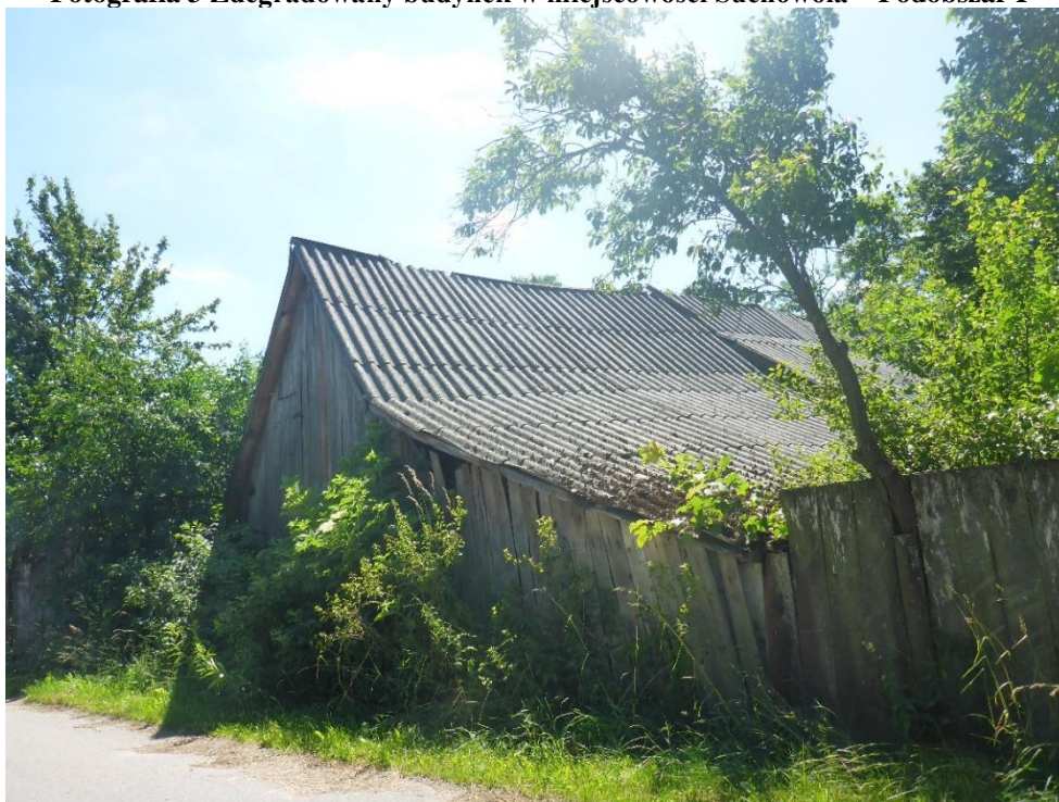
Fotografia 3 Zdegradowany budynek w miejscowości Suchowola – Podobszar I
