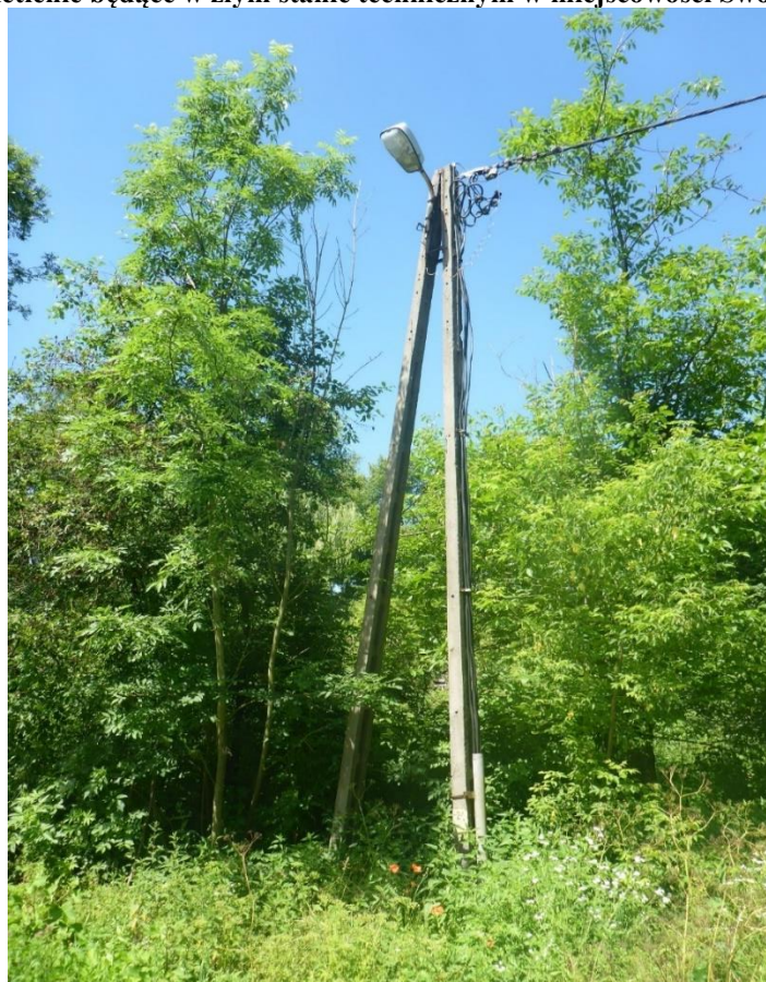
Fotografia 1 Oświetlenie będące w złym stanie technicznym w miejscowości Sworóń – Podobszar II
