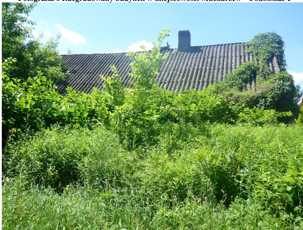
Fotografia 6 Zdegradowany budynek w miejscowości Mucharzew – Podobszar I
