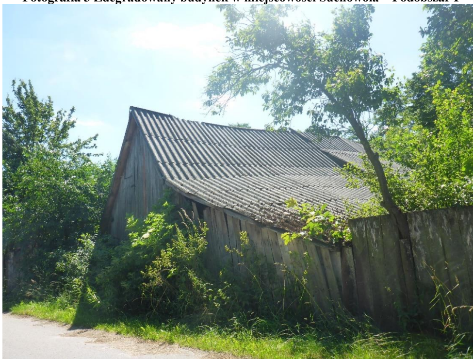
Fotografia 3 Zdegradowany budynek w miejscowości Suchowola – Podobszar I
